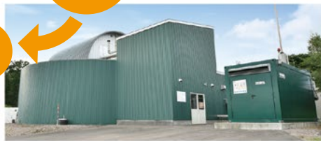
●バイオガスプラントで牛フンを発酵、そして発電!!
